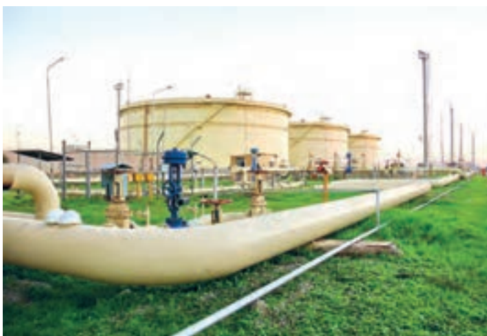
شکل ۲۱- نمایی از خطوط انتقال سوخت
