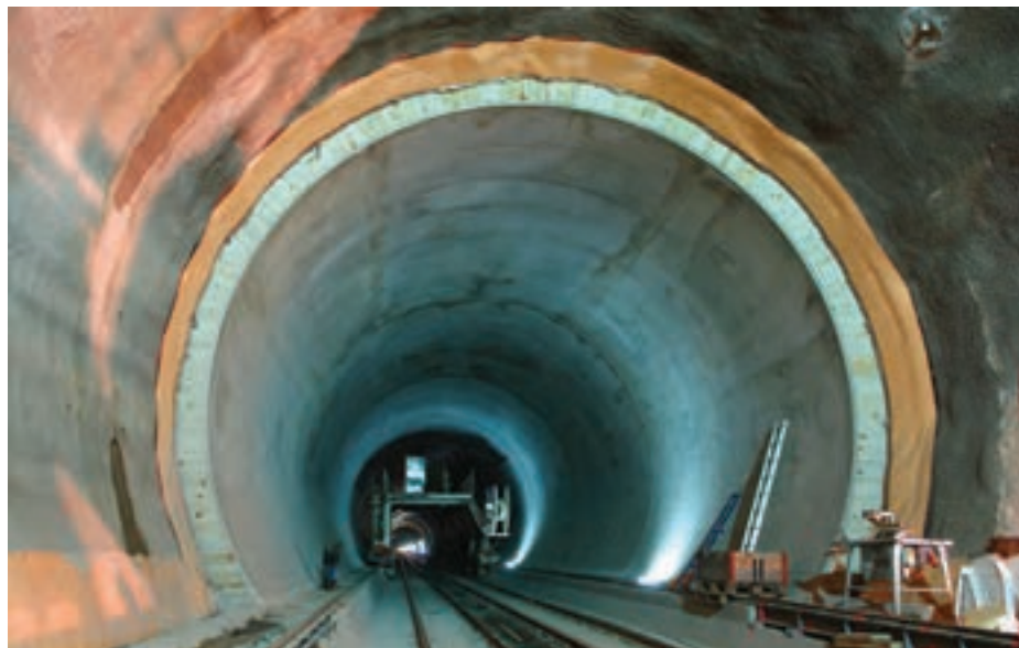
شکل ۴-۶- پوشش داخلی تونل به وسیله قطعات بتن
